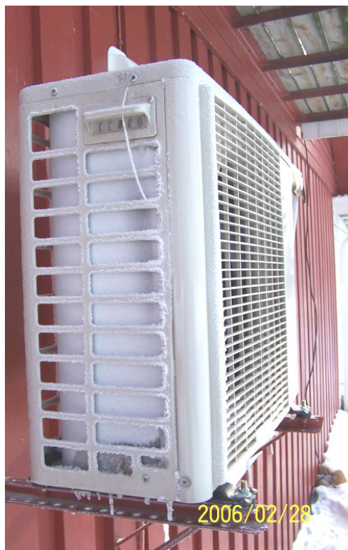
Bild: M.Berkelder. IVT uteluftvärmepump. Påtaglig påfrostning. Utetemp -11,5 °C
